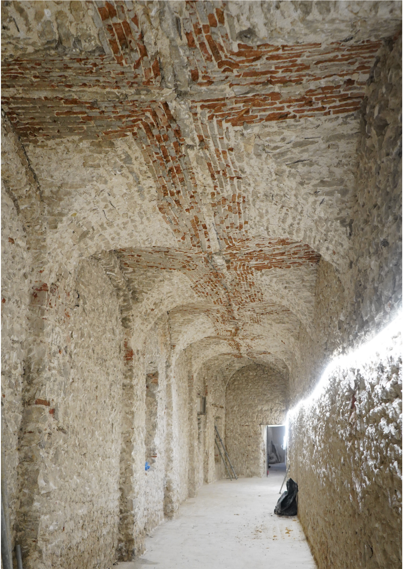
Vue de l'intérieur du Couvent Saint-François, en cours de restauration. La galerie principale du rez-de-chaussée qui deviendra un espace d'exposition. Mairie de Bonifacio.
